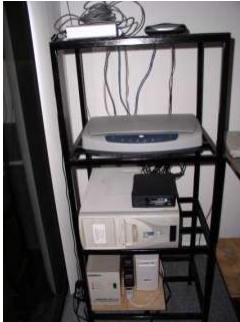
Le serveur de la Bibliothèque Numérique une fois installé En haut se trouve l'équipement réseau avec le modem ADSL et en bas les appareils de stabilisation électrique.
